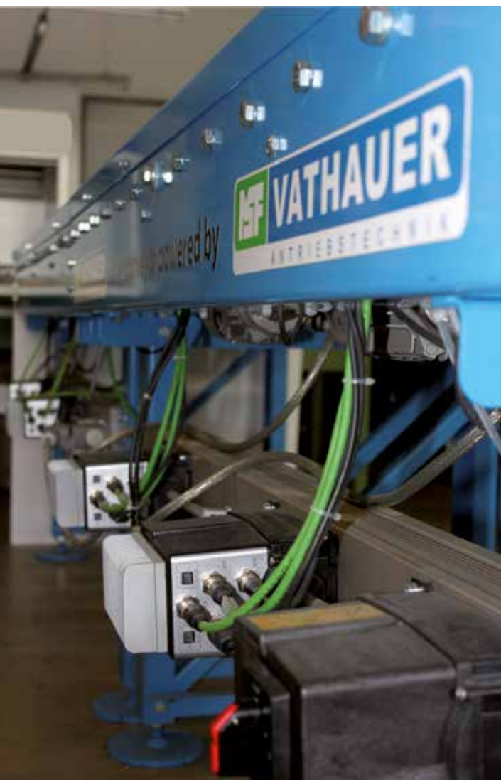
Das Field Drive System in einer beispielhaften Anlage in Aktion.
